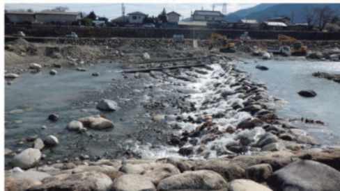
流路工下流の局所洗堀、魚道機能が失う原因
