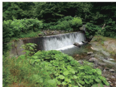
治山堰堤の改良前
