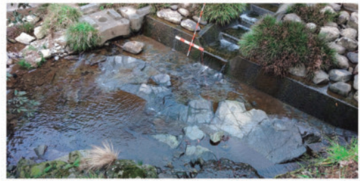
堰堤下流で河床低下した状態
